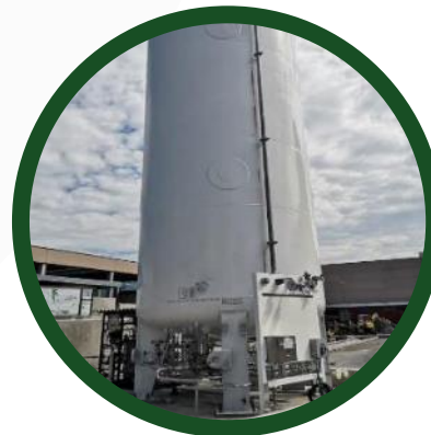
LNG Refueling Station
